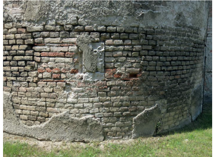
Instandsetzung, Reparatur: Um das Mauerwerk zu schützen, sollten fehlende Putzstellen wieder in Stand gesetzt werden.
