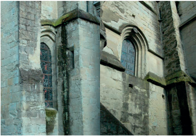
Kathedrale Lausanne, 12.-13. Jh., aufgrund von defekten und über Jahre nicht reparierte Dachrinnen entstandene Wasserschäden an der nördlichen Langhausfassade
