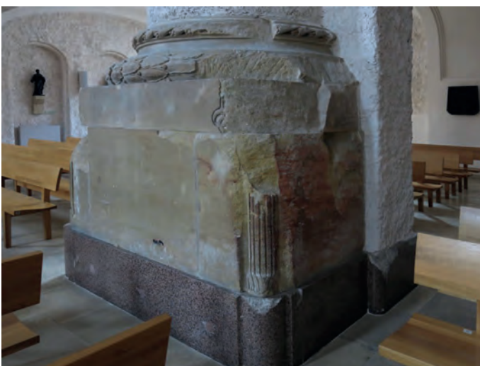
Dresden, Kreuzkirche nicht restaurierte und rekonstruierte Stützenbasis mit Kriegsschäden.
