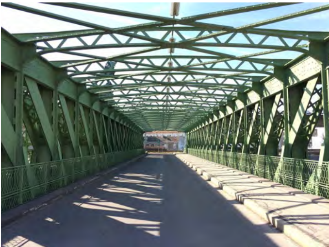
Gebrauchswert; Eiserne Fachwerkbrücke bei der Nussdorfer Schleusenanlage am Donaukanal in Wien sog. Schermerlbrücke, benannt nach dem k.k. Hofbauratsdirektor Josef Schermerl Ritter von Leytenbach, 1894-1899 von Otto Wagner geplant.
